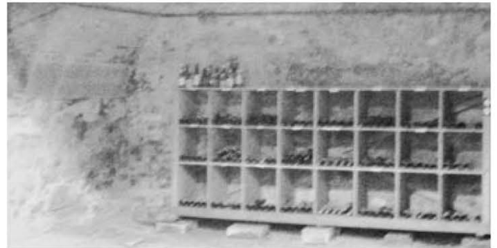
Und von innen: Die feuchten Gewölbekeller der Liegenschaft vor der notwendigen Mauerentfeuchtung.
